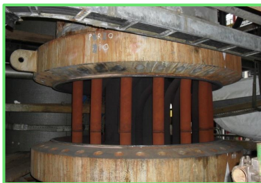
Interno caldaia ristrutturata
