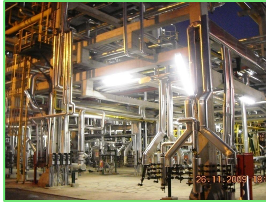
IES Mantova Refinery HDS-1, FLARE, MHC, ARU 3, HDS 3 Centrale Elettrica
